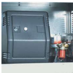
Ölbrenner mit Ölvorwärmung
