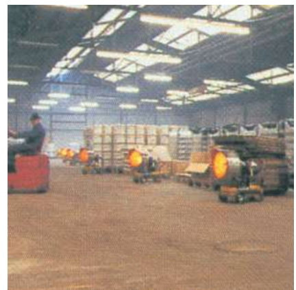
Arbeitsplatzbeheizung in großen Lagerhallen
